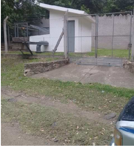
Sala de bombeo y sus caños que vierten al arroyo
